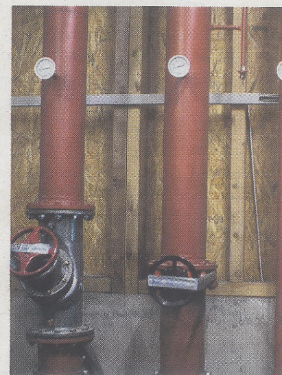
Durch diese Leitungen fliesst Wärme in Form von heissem Wasser.
