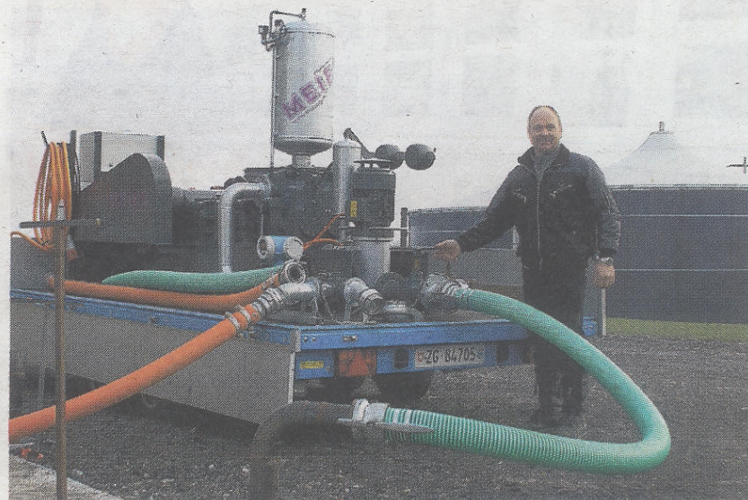
Die mobile Pumpe fördert Gülle von den Höfen über Leitungen direkt zum Kraftwerk.
