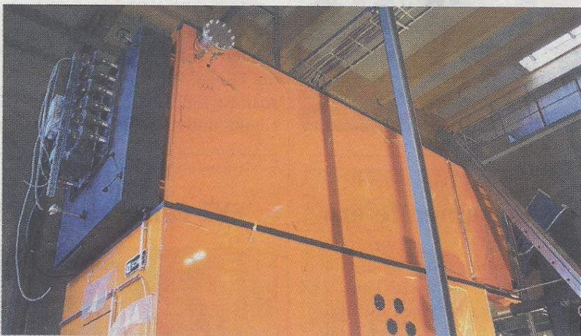
Die erste Holzschnittelheizung des Biomasse-Heizkraftwerks.
